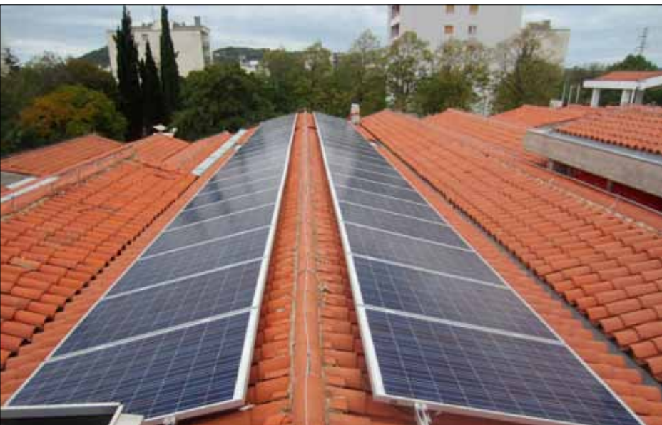
Slika 11, Raspored fotonaponskih panela na krovu, pogled S (jug)
