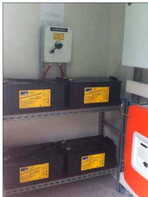
Slika 16, Baterije i glavna sklopka za baterije
